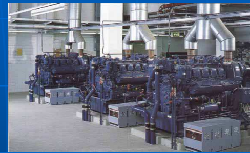
Industrielle/Kommunale Anlagen 1 – 10 MW mit ZSV
